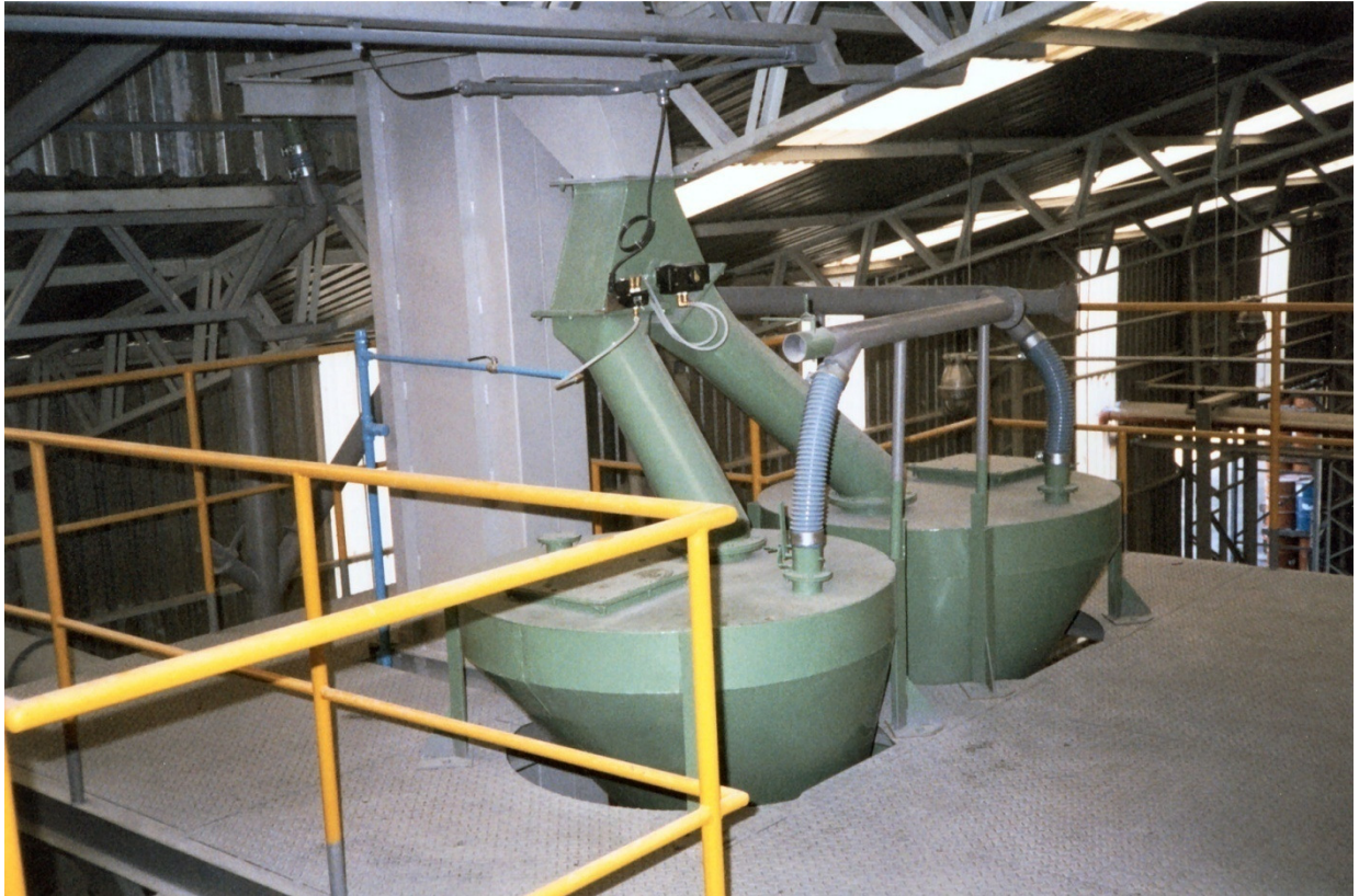
DESCARGA DO ELEVADOR DE CANECAS PARA OS SILOS SI-02A E SI-02B
