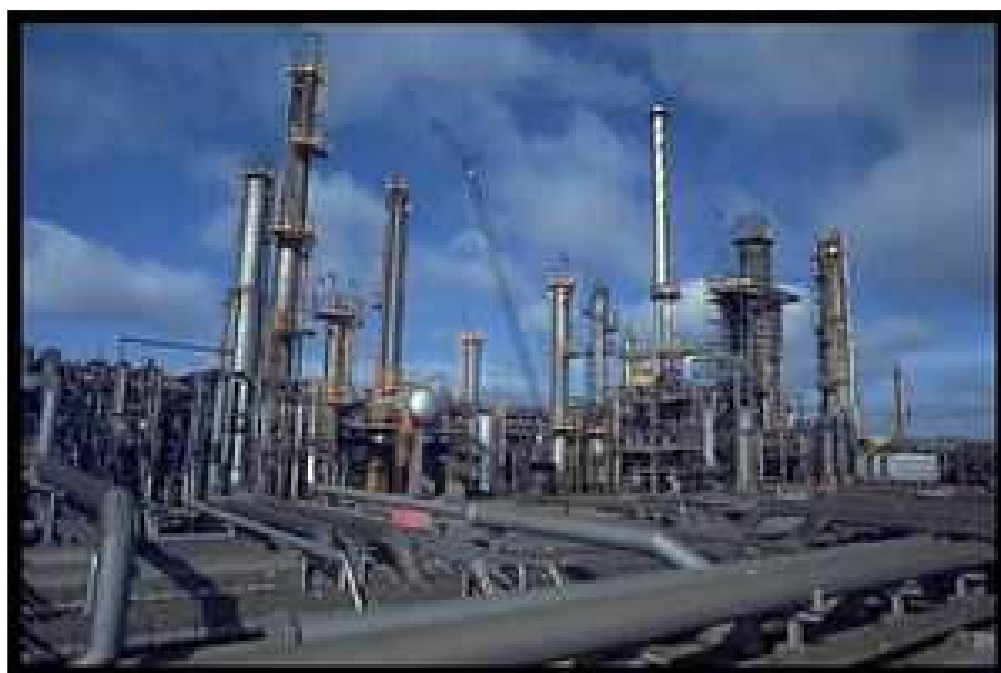
FIGURA 1- EMPREGO DE TUBULAÇÕES INDUSTRIAIS EM REFINARIA DE PETRÓLEO.
